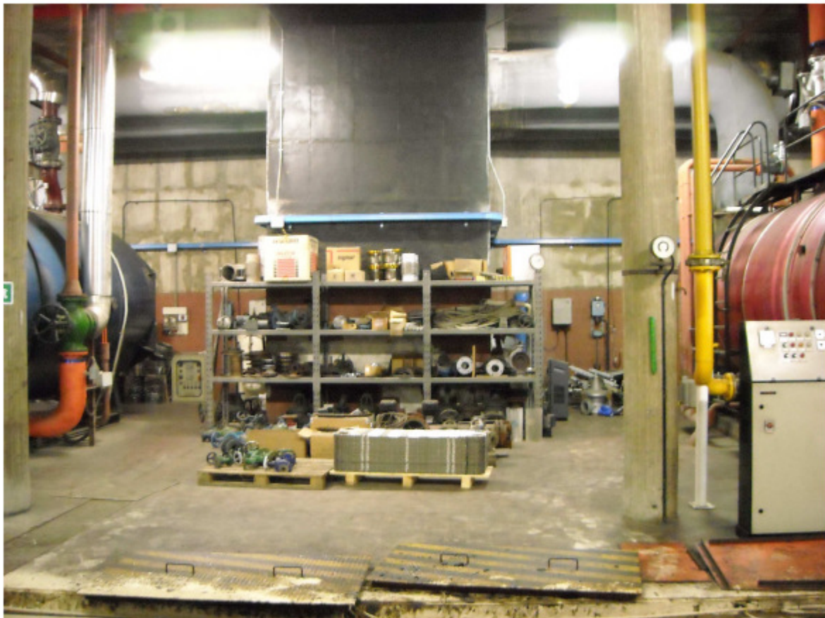
Fig. 3.6 – Area di ricovero impianto cogenerazione
